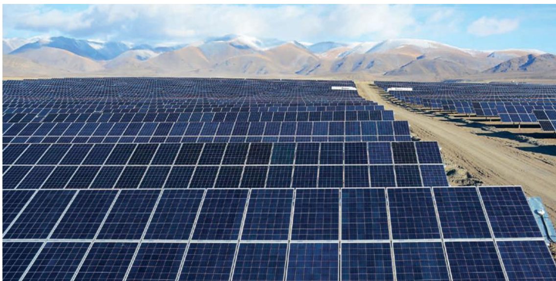
Рис. 5. Солнечная электростанция в селе Кош-Агач Республики Алтай.
