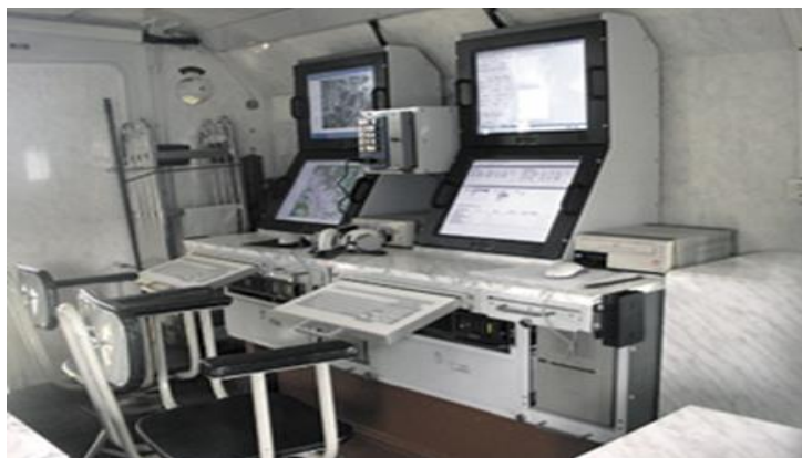
Рис. 15. Вариант оборудования постов управления ЛРТС и СРТС.
